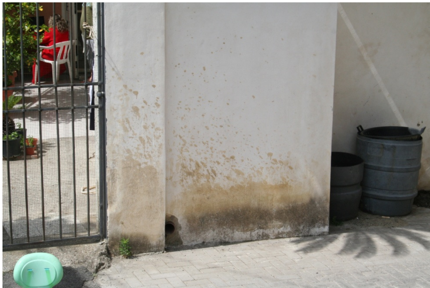
Figura 7 – Tracce di una recente esondazione del Torrente Galati sul muro di cinta di un'abitazione a Galati S. Lucia
