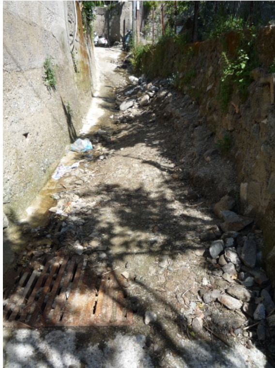
Figura 10 – Particolare delle griglie per lo smaltimento delle portate subito a monte di Mili San Marco
