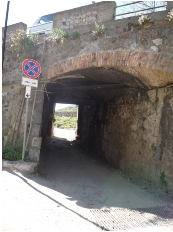
Figura 8 - Tombino che collega la piazza di Mili San Marco direttamente all'alveo del torrente, visto dalla piazza.
