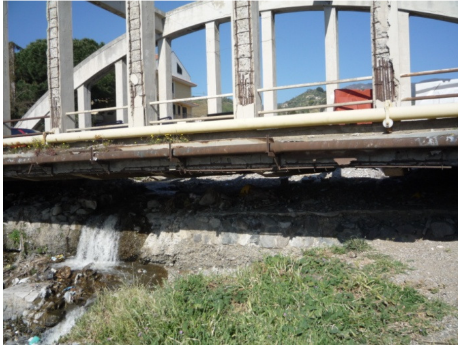
Figura 7 – Sezione d'alveo del Torrente Mili localizzata in corrispondenza di Mili Marina: il ponticello pedonale ostacola il deflusso delle portate.
