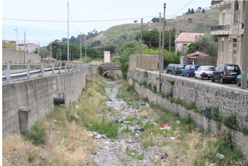
Figura 8 – Depositi di materiale detritico e rifiuti lungo il torrente Zafferia
